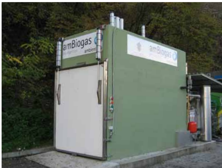
L'impianto con il portellone frontale.
