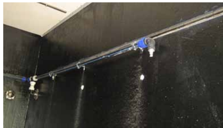
Particolare aspersione percolato.
